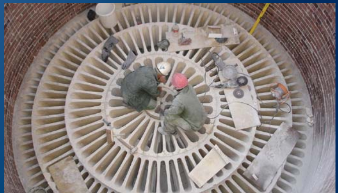
Keramischer Kuppelrost in einer Säureproduktionsanlage
