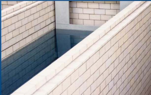
Behandlungsbad in einer Oberflächenbehandlungsanlage
